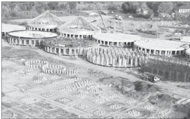
Вид на строительную площадку будущего - одного из самых крупных в стране - маслоэкстракционного завода в Бузулуке.
